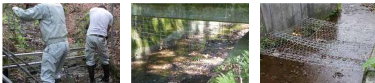
■ 山間部の小川は、降雨の度に落ち葉等が堆積するため、常に維持管理・メンテナンスが必要です。 ■ 大雨の際に、堆積物と流水圧によって金網が破損し、そのまま放置されています。 ■ 護岸にしっかり固定できていなかったのか、金網が倒れてしまったまま放置されています。
